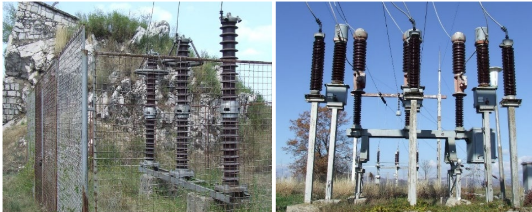
Slika 7. Klasični 110 kV odvodnici prenapona (lijevo) i odvodnici prenapona sa magnetnim oduvavanjem luka (desno)
