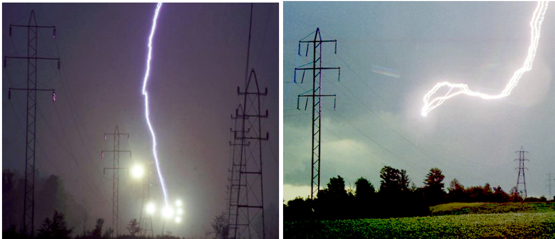
Slika 25. Atmosfersko pražnjenje u dalekovod bez odvodnika prenapona (lijevo) i dalekovod sa ugrađenim odvodnicima u svakoj fazi na jednom sistemu provodnika (desno)
